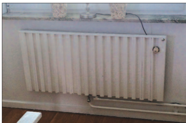
Före bytet: HE-radiator installerad 1965
